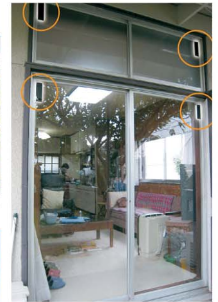
引き違い窓の左右上部の2カ所と上部窓にも2カ所、内側にガラス割れセンサーと発報装置を装着=神戸市の住宅
